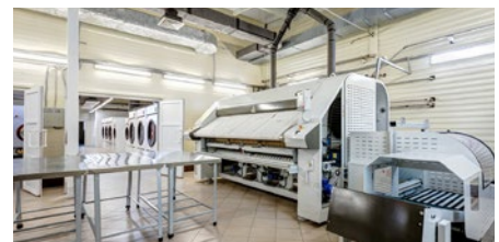
Sistema de lavandería automatizado
